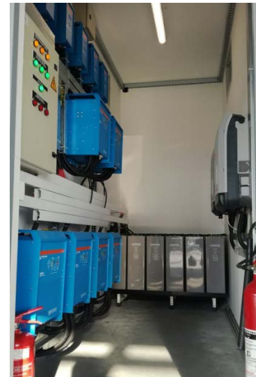
Slika 6. Tehnička soba u kojoj je smešten sistem sa baterijama, invertorima i AC razvodom
