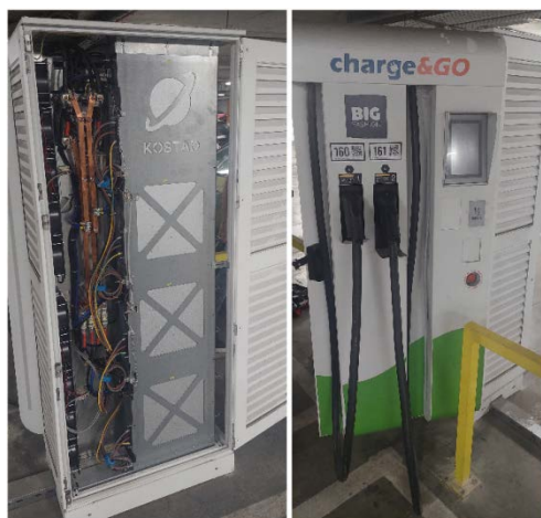
Slika 14. Izgled (zadnji i prednji deo razvodnog ormara) punjačke stanice KOSTAD UNITY 120, izlazne snage 120 kW
