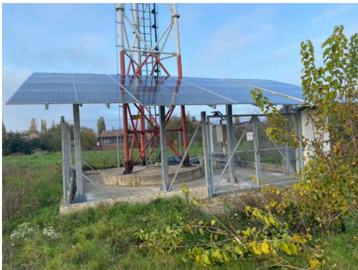
Slika 7. Izgled PV elektrane 8kW za napajanje bazne stanice
