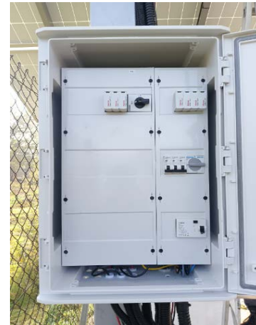
Slika 8. Izgled razvodnog ormana FNE bazne stanice
