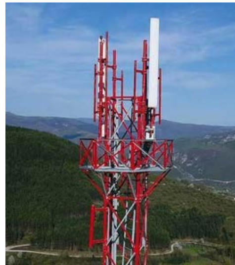
Slika 1. Izgled vrha rešetkastog stuba jedne radio bazne stanice
