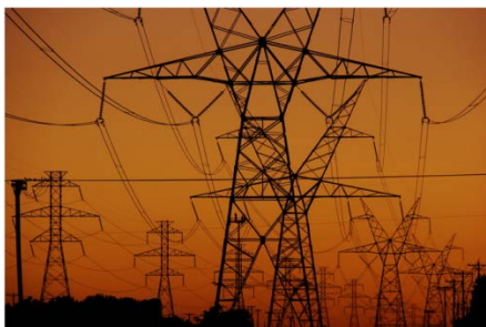
Slika 1. Oblik nadzemnih strujnih vodova (Izvor: https://upload.wikimedia.org/wikipedia/commons/f/f3/PylonsSunset-5982.jpg )
